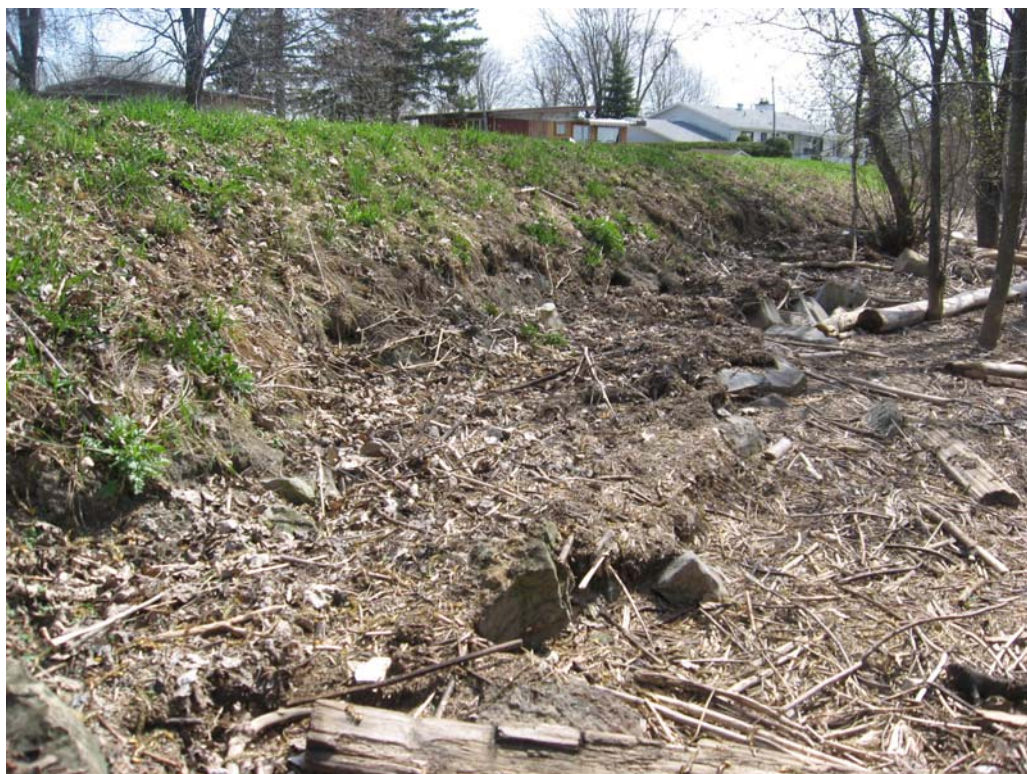
Photo 3 : Érosion et enrochement au pied du talus, secteur sud
