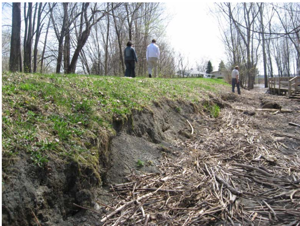
Photo 1 : Érosion importante dans le secteur de la promenade en bois
